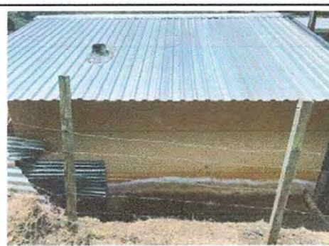
Foto 6: Repello y alisado en muro de (cocina) MÓDULO 3
