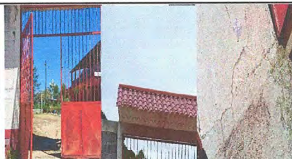
Foto 10: MURO PERIMETRAL Sustrucción de portón, Sustrucción de canal de metal, Reparación de plancha de concreto
