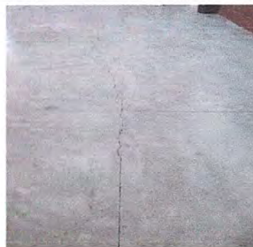
Foto 2: Modulo 1: Sustitución de piso cemento líquido por piso cerámico
