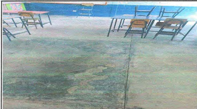
Foto1: Módulo1 Piso de aulas en mal estado
