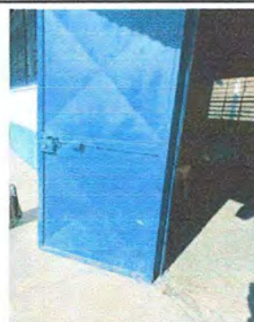
Foto 4: Modulo 1 Losa del corredor de la escuela en mal estado. Reparación de puerta de metal.
