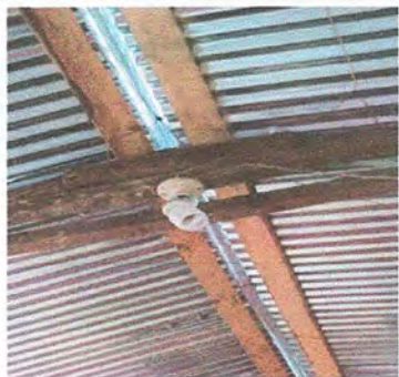
Foto 7 MODULO 1 INSTALACION DE UNIDADES LUZ (INCLUYE INTERRUPTOR DUCTO Y CABLE ELECTRICO)
