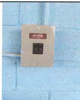
Foto 9: Modulo 1 Sustitución de flípones
