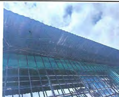
Foto 2: MODULO 1 - SOPORTE DE ESTRUCTURA METAL
