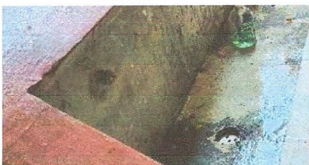
Foto 11: Módulo 1 Instalación de chorros
