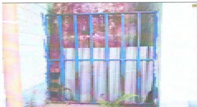
Foto 3: Muro perimetral. Sustitución de puerta de metal (1 metro x 2.75)
