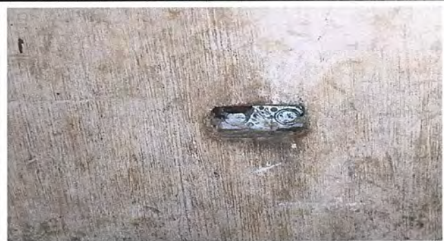
Foto 21. Módulo 4: Suministro de tomacorrientes dobles.
