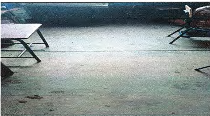
Foto 3: Módulo 2 Sustrucion de torta de concreto por piso cerámico
