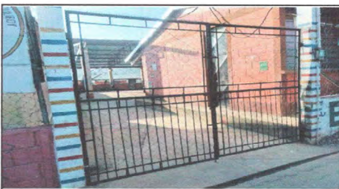
Foto 4: MURO PERIMETRAL. Sustrucción de portón de metal
