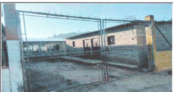
Foto 5: MURO PERIMETRAL Sustrucción de portón de metal
