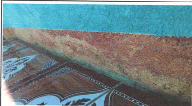
Foto 13: Módulo 2. Pinturas en muros exteriores e interiores.
