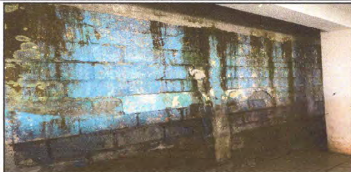
Foto 1: Estado actual del muro de contención del techado que esta enfrente de las tres aulas por filtración de agua en la parte de arriba, se necesita ser reparada.
