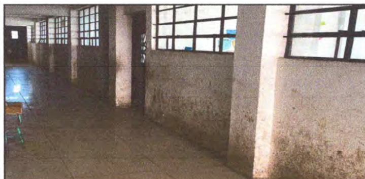
Foto 3: El corredor y dentro de los salones de clases actualmente se encuentra muy sucias, se necesita ser pintadas.
