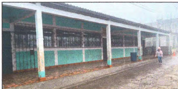
Foto 4: Actualmente la pintura del establecimiento esta deteriorado, se necesita pintar.
