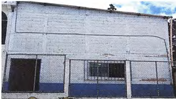
Foto 5: Repello de pared de block.
