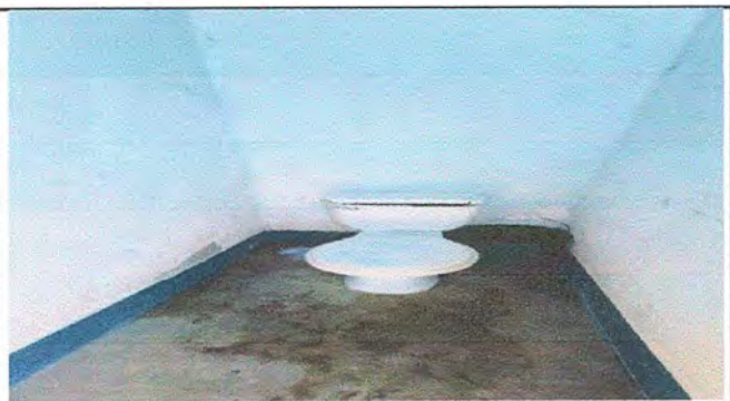
FOTO 9: BAÑO A SUSTITUCION DE INODORO
