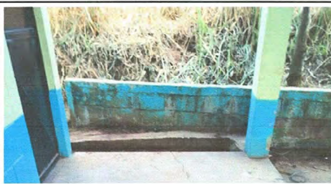
Foto 4: Módulo 1 Pintura en muro exterior
