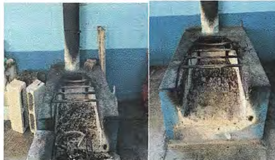
Foto 10. Módulo 2: Sustitución a estufa rural.
