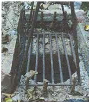
Foto 9 Módulo 3 Sustrucción de rejilla para aguas Pluviales
