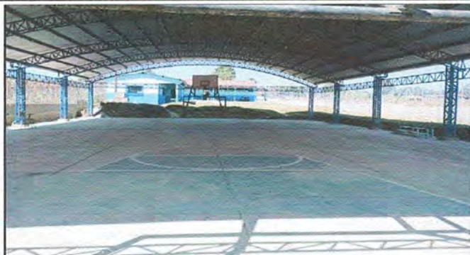
Foto 25. Pintura en cancha polideportiva
