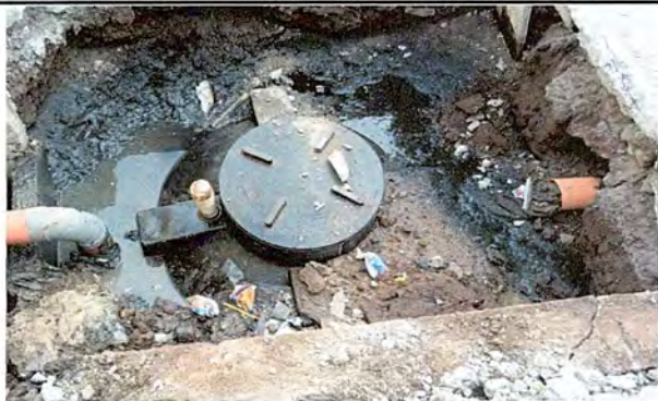
FOTO 1: AREA EXTERIOR: LIMPIEZA DE BIODIGESTOR
