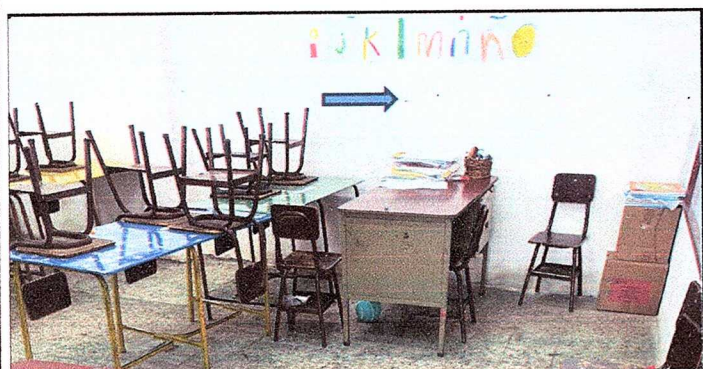
Modulo 2, foto 3: Pintura en muros exteriores e interiores
