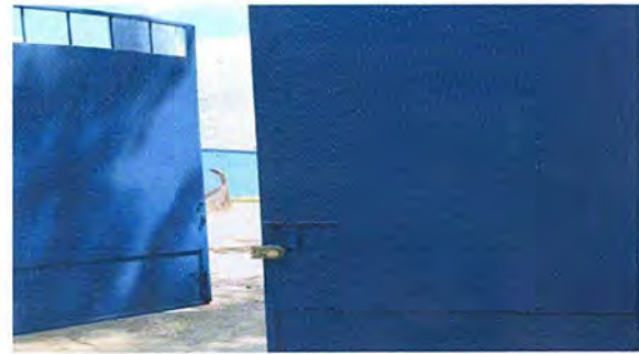
Foto 2: INGRESO: SUSTITUCIÓN DE CHAPA
