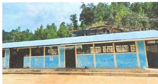
Foto 5: Pintura en muros extremos M2
