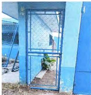
Foto1: MURO PERIMETRAL. Puertas de metal, sustitución de puerta.
