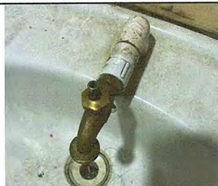
Foto 6:BAÑO: Chorros de lavamanos deteriorados
