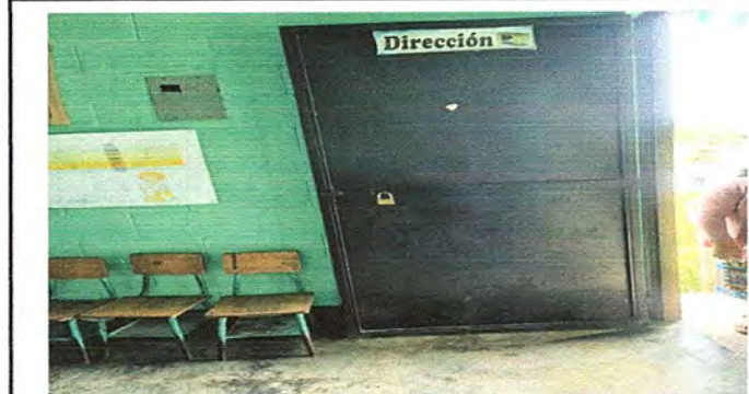
Foto 4: MODULO 2: Sustrucción de chapa
