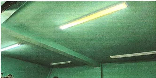
Foto7: MODULO 3: Sustitución de lámparas 2x40
