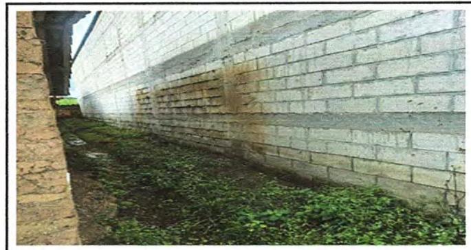
Foto 6: MODULO 3: Repello más tallado en muro
