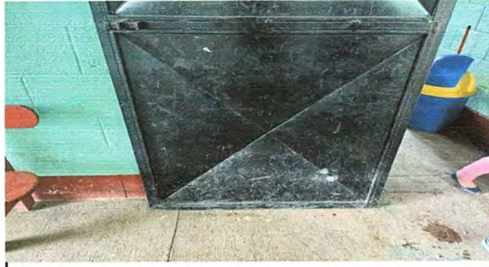
Foto 2: MODULO 1: Sustrucción de chapa
