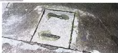
Foto 5: Módulo 2: Mantenimiento de biodigestores
