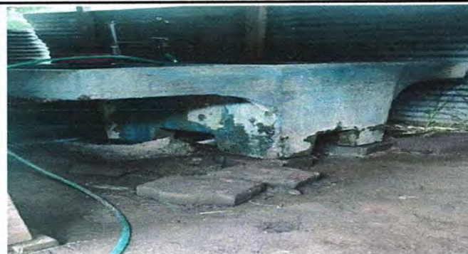
Foto 8: Sustrucción de pila de cemento de dos lavaderos. Sustrucción de piso de torta de concreto. MÓDULO 1
