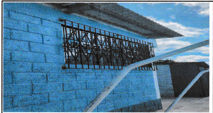
Foto 4: Sustrucción de balcón
