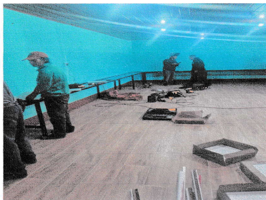
Mantenimiento de comedor con mesas metálicas fijas
