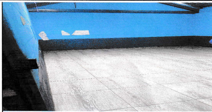
Foto 1: Sustrucción de piso cerámico en aula
