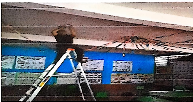
Foto 5: SUSTITUCION DE LÁMPARAS A FOCOS
