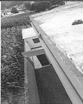
Foto 5: bajadas de Agua
