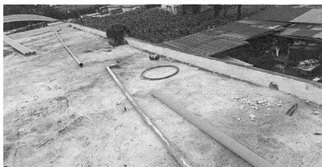
Foto 5: Bajadas de agua
