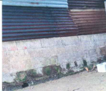
FOTO 8. REPELLO GRIS EN MURO
