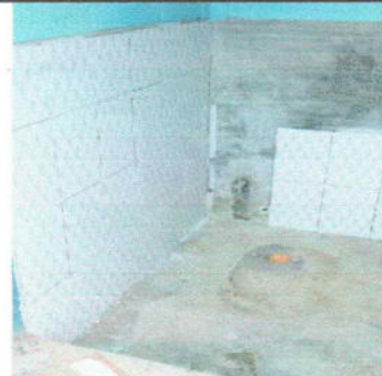
Foto 2: Sustrucción de azulejo en sanitario
