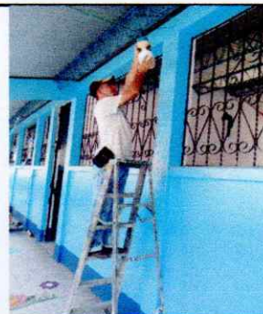
Foto 10: Sustitución de lámparas existentes con lámparas bombillo LED GLOBO 30 W para pasillos 2400 lúmenes
