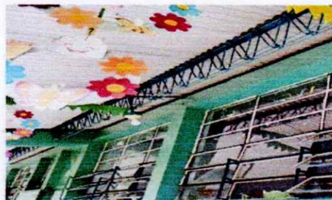
Foto 10: Sustitución de lámparas existentes con lámparas bombillo LED GLOBO 30 W para pasillos 2400 lúmenes
