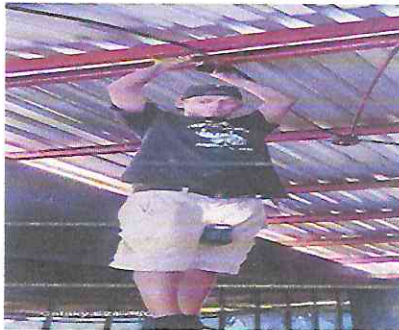
FOTO No.10. Sustitución de 12 bombillos LED GLOBO 30 W 2400 Lúmenes
