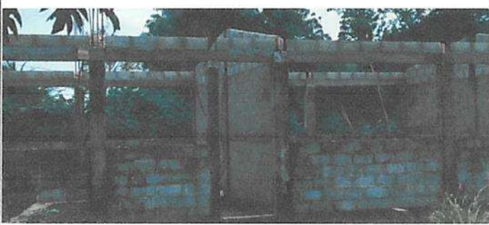
Foto 3: Sustrucción de balcon de metal
