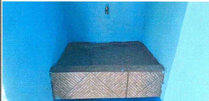
Foto #7: Sustrucción de lavamanos de concreto. 2 lavamanos de concreto
