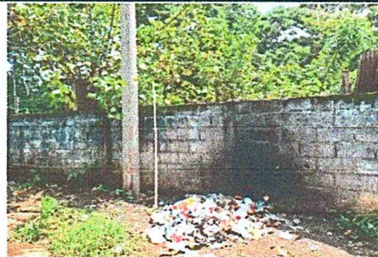
Foto No. 8 Repello gris en muro
