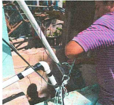
SUSTITUCION DE BOMBA SUMERGIBLE 1/2 HP USO RUDO, TRUPER. ALTURA MAXIMA 18 M, 97 LPM
