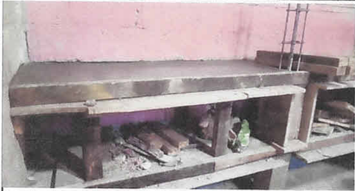
Foto7: Sustrucción de repisa de madera por concreto, en cocina
