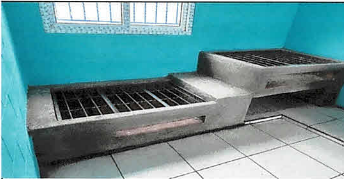
Foto 6: Sustrucción de estufa con ladrillo y chimenea de metal en cocina 7 mts.2
