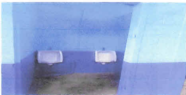
8, Sustitución de mingitorio, 2 unidades
