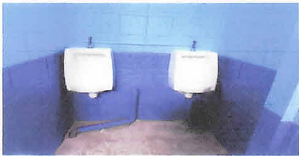
7, Sustitución de mingitorio, 2 unidades.
