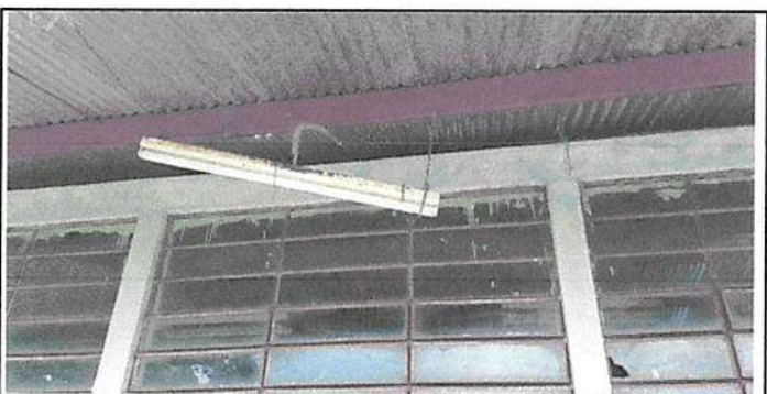
Sustitucion de lamparas existentes con lamparas bombillos led globo 30 w para pasillos 2400 lumenes
