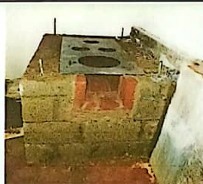
Sustitución de estufa de leña tipo polleton en cocina.
