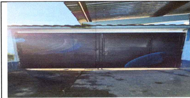
Foto1: Sustrucción de portón metalico.
